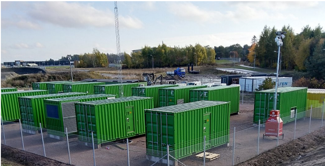
Batterilager i Uppsala, Foto Vattenfall
