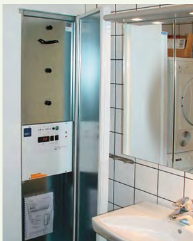
Ett FTX-aggregat tar inte stor plats. Det bör placeras lättillgängligt så att du enkelt kan byta filter.
